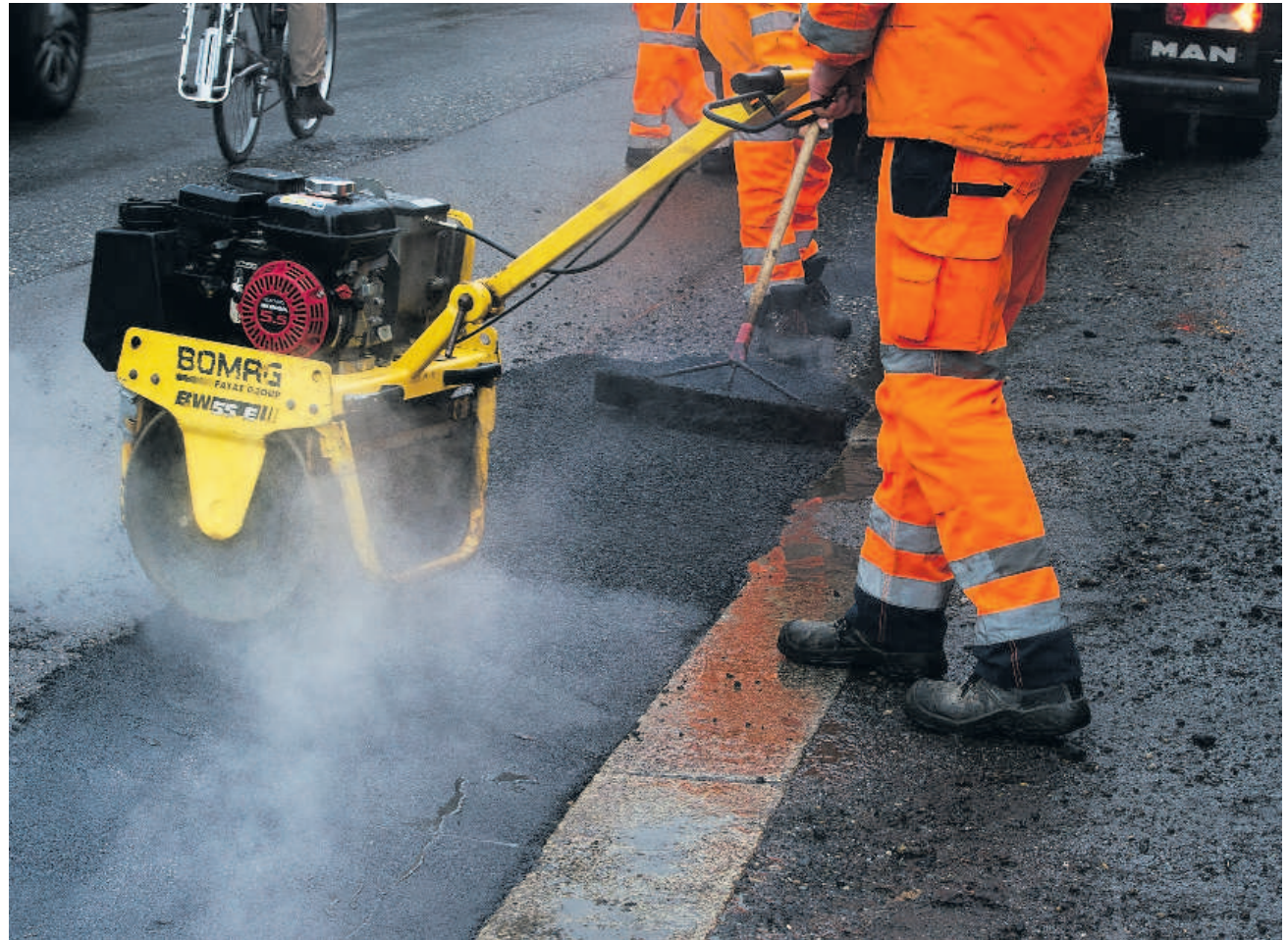
Flickwerk: Wenn eine Straße saniert werden muss, können Kommunen die Anwohner mit Beiträgen zur Kasse bitten.
