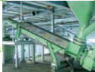
Presse der Kompostierungsanlage im Landkreis Weißenfels
